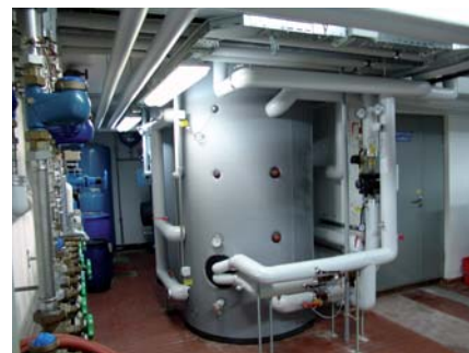
Sopra, stoccaggio acqua calda da solare. In basso, recupero calore dai gruppi frigoriferi (in costruzione).
